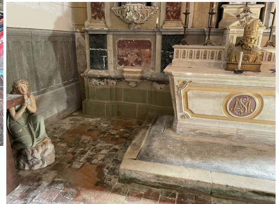
Travaux à l'intérieur de l'église : dégagement et nettoyage de la zone autour de l'autel, avec évacuation des gravats Vue de l'autel avant restauration, montrant les dépôts, l'humidité et l'état général nécessitant une intervention
